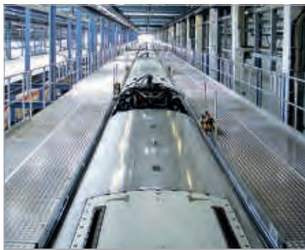
Poste de travail stationnaire au niveau du toit avec une longueur d'env. 920 m pour la maintenance de l'ICE
