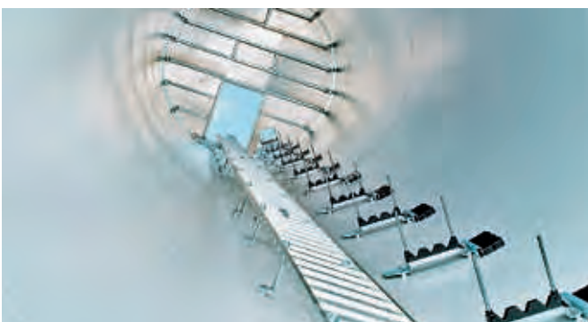
Système d'échelles d'ascension pour éolienne (voir p. 326)
