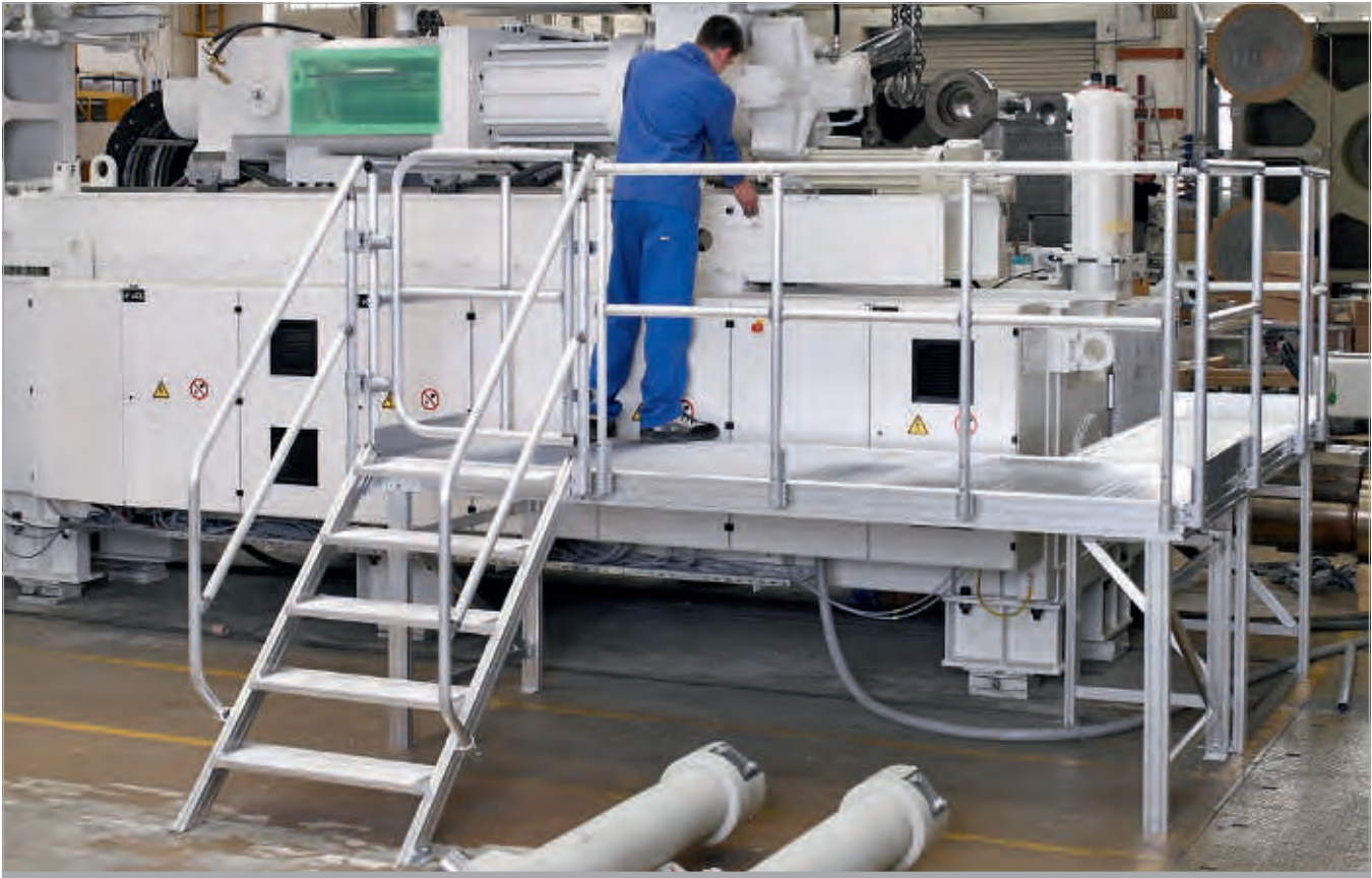
Plate-forme de travail avec accès par escalier, contour adapté à l'installation
