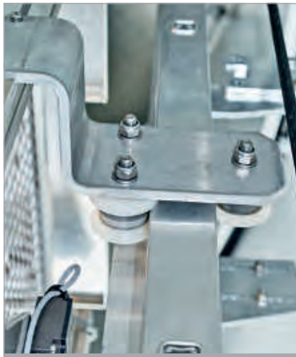
Détail de l'ascenseur de service
