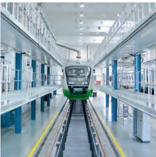
Echafaudages de maintenance / Poste de travail stationnaire au niveau du toit pour les trains
